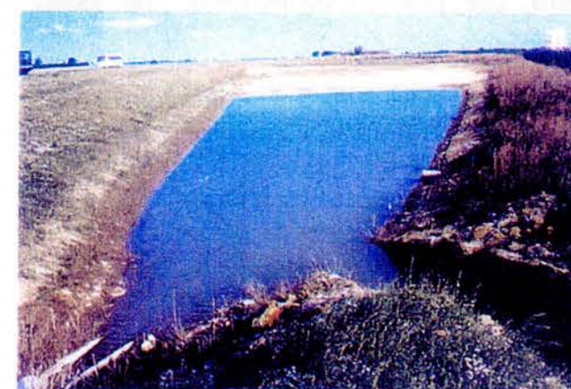
Bassin de décantation des eaux pluviales de la route périphérique nord, vers Mauregard
