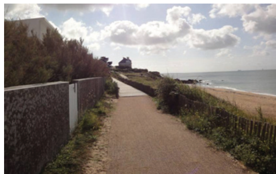
L'ancien platelage très abîmé a été démonté mais n'a pas encore été remplacé, faute de financement. Un géotextile en coco permet d'assurer un certain niveau de confort à la marche mais sa dégradation sous l'effet du piétinement est rapide.
